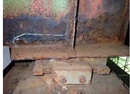
写真-1 G4 桁端部 (A2 側) の腐食状況
