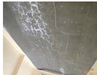
写真-3 エフロレッセンス
