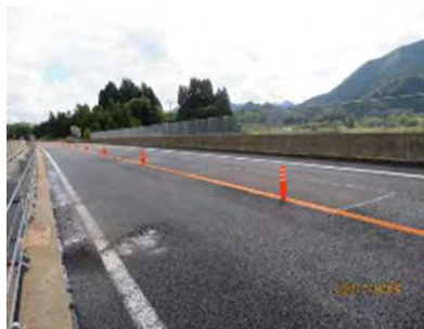
写真-1 ポットホール
