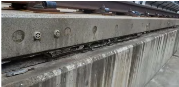
写真-1 スラブてん充層劣化状況写真
