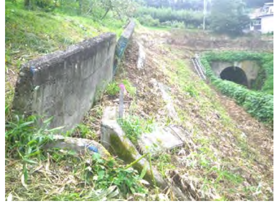
写真-1 鉄道トンネル付近法面排水溝の破損
