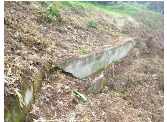
写真-2 堅壁部の破損と排水溝土砂堆積
