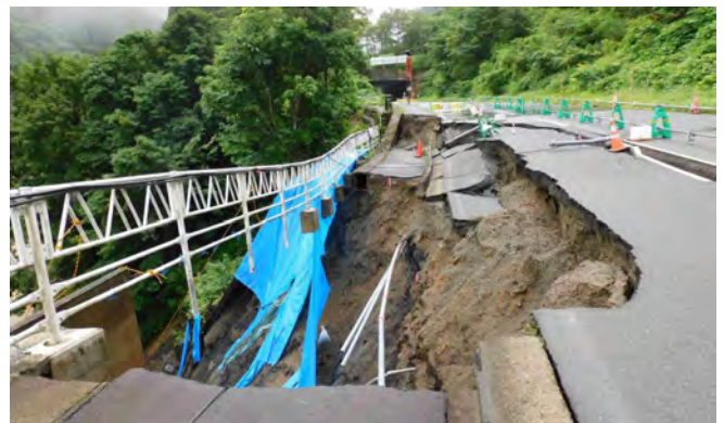
写真-1 国道川側部の滑落（米沢側より望む）
