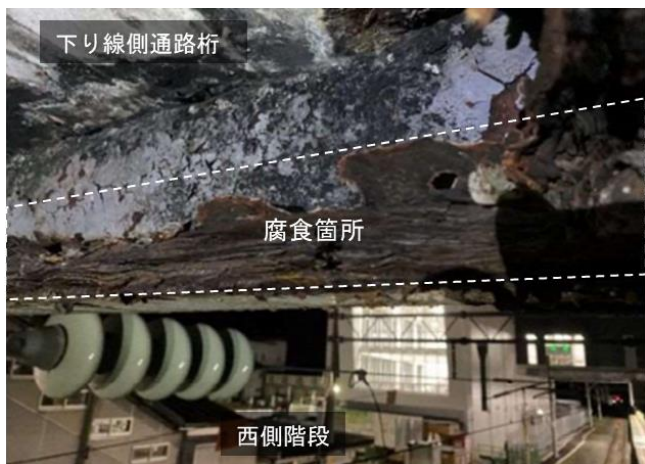
図-4 トラス主桁の腐食状況
