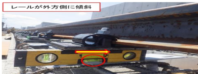
写真-1 レールが外方側へ傾斜している状況
