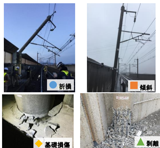
図-2 電化柱の損傷内容
