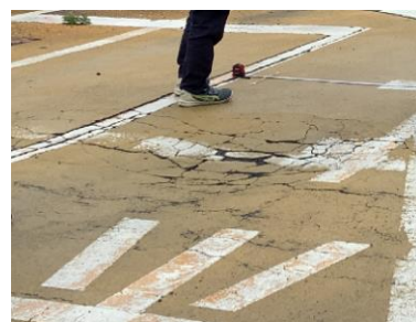
写真-1：表層の経年劣化の様子
