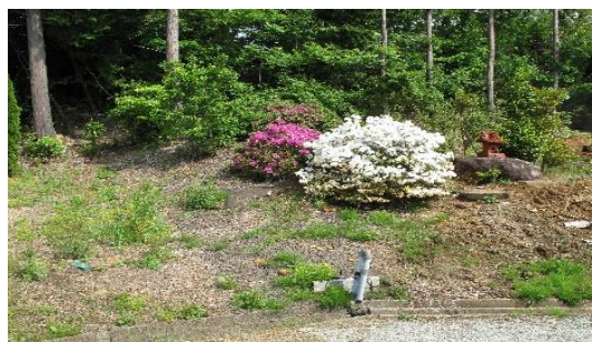
写真1 家庭用人工湿地の外観
