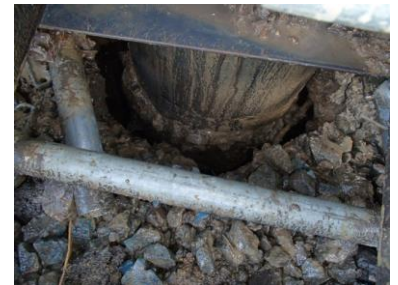
写真－2 路盤陥没状況
