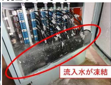
写真：システムＢＯＸの凍結状況
