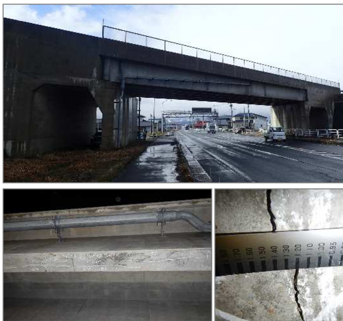
写真-1；変状発生状況
