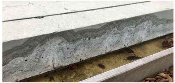
図-2 塩水吸い上げ状況(ひび割れあり)
