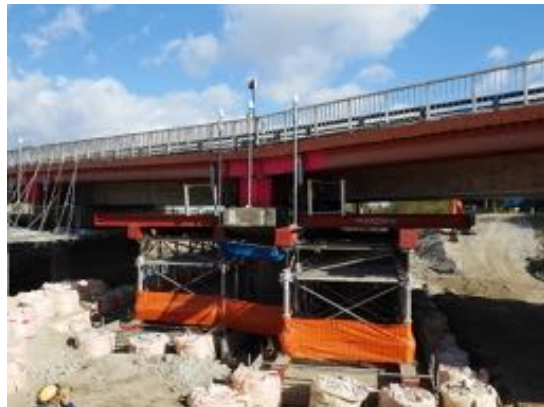
写真-1 大善寺橋の被災状況
