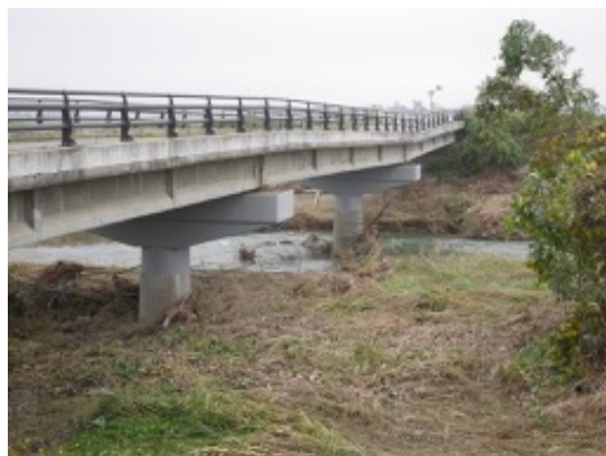
写真-2 銀山橋の被災状況
