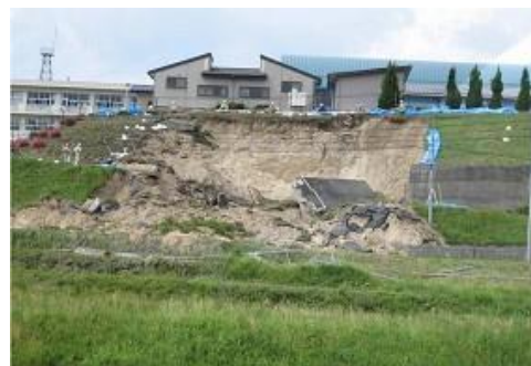
写真-1 重力式擁壁の崩壊(2008)
