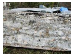
写真-1 取替前 床版の劣化状況
