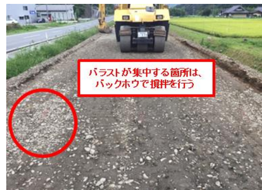
写真-3. スタビライザー攪拌後のバラスト集中箇所
