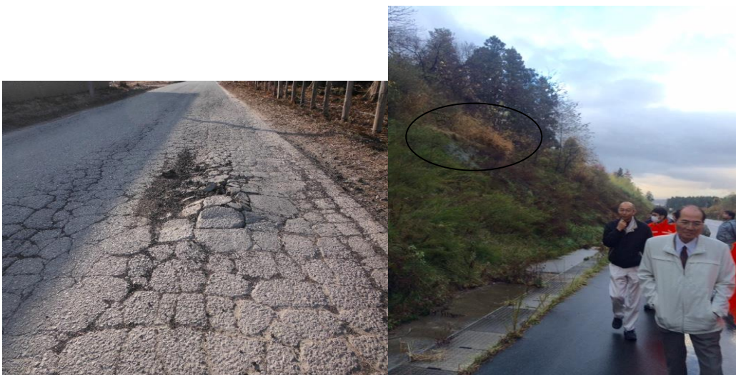
図-1 生活道路の舗装面のクラック事例
