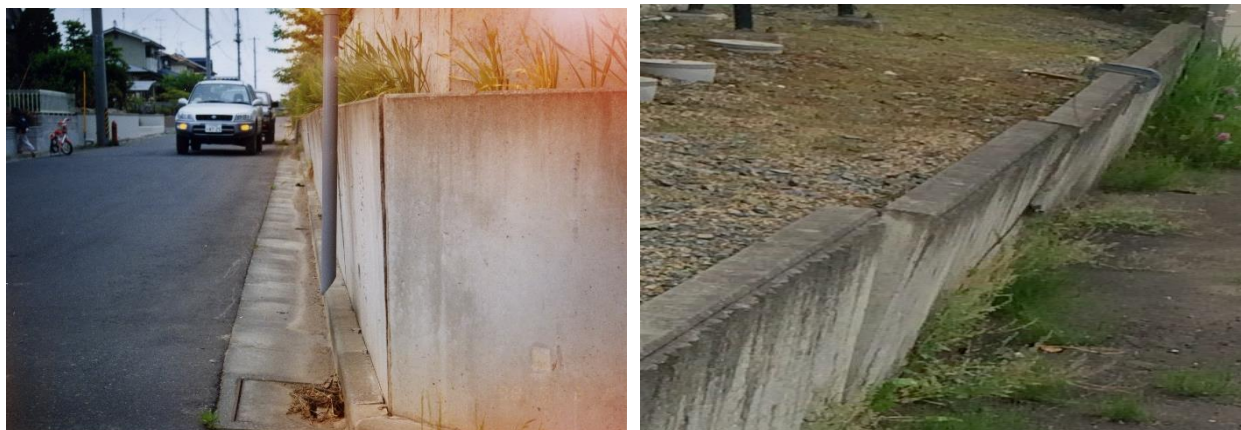
図-3 宅地擁壁の変位事例
