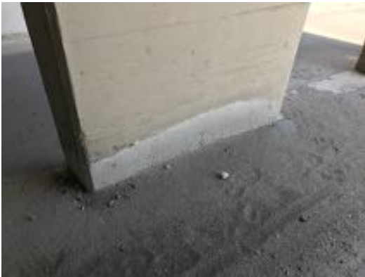
写真-1 吸い上げの影響を受けたと考えられる部材
