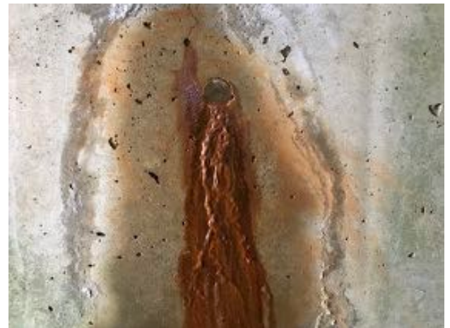
写真-1 沈みひび割れからの漏水
