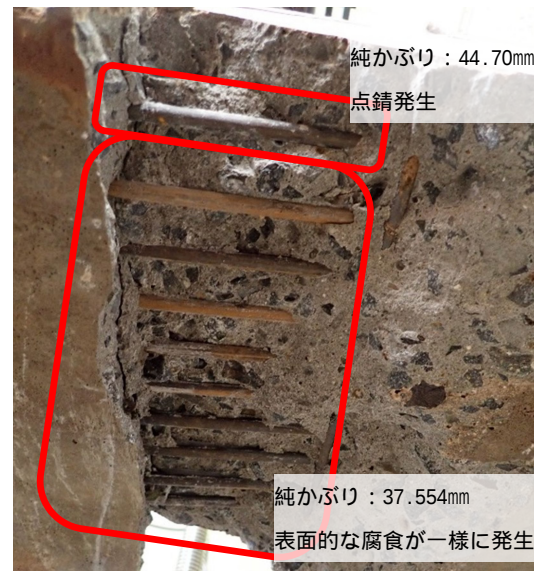
写真-2 No.2 桁の鋼材の腐食状況
