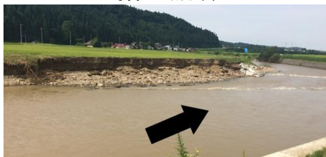
写真-2 洗掘された護岸
