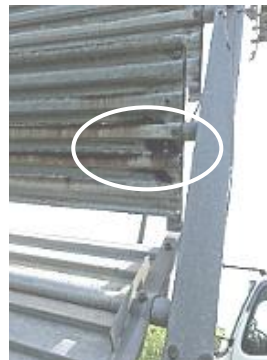
写真1. 防雪板の腐食状況
