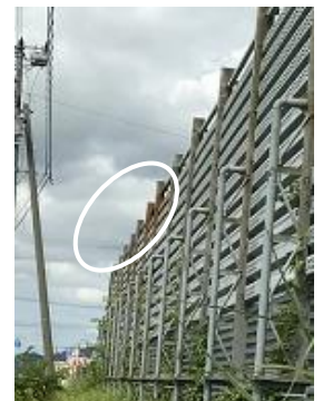
写真2. 支柱の腐食状況
