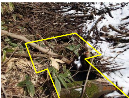
写真-2 パイプカルバート呑口の土砂詰まり
