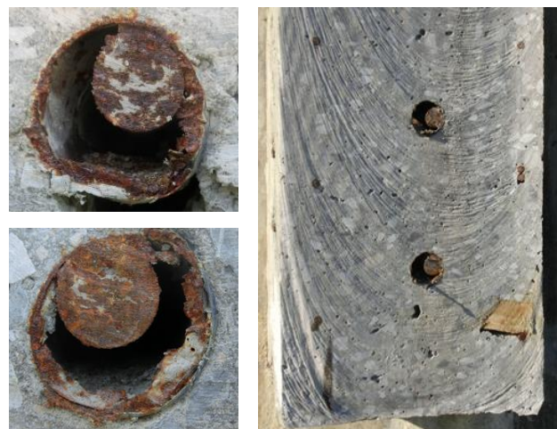
写真-4 横桁切断面（未充填）
