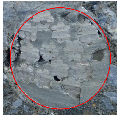
写真-3 主桁切断面（拡大）
