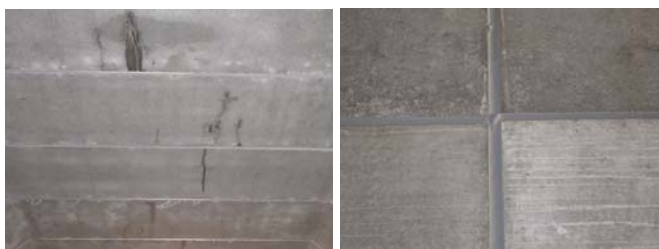
写真-1 ひび割れや段差・目地のズレの状況
