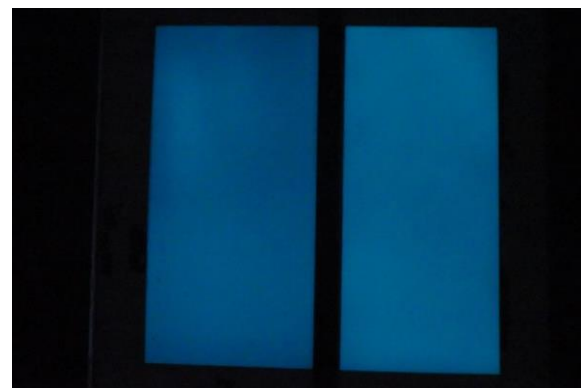
写真-2 蓄光材料を塗布した避難誘導タイル
