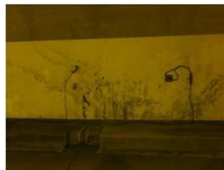
写真2 側壁ひび割れ状況
