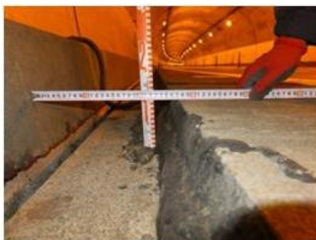
写真1 路面隆起状況
