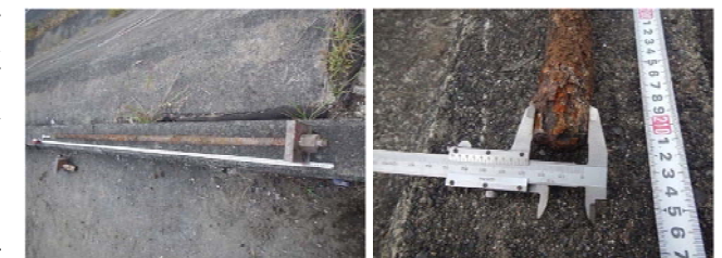
写真-3 破断アンカー状況（左：全景，右：破断面）
