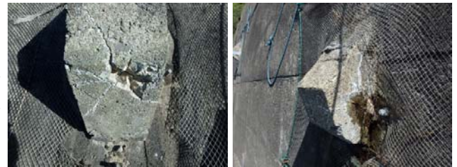
写真-2 頭部保護具変状状況（左：F-9，右：D-8）
