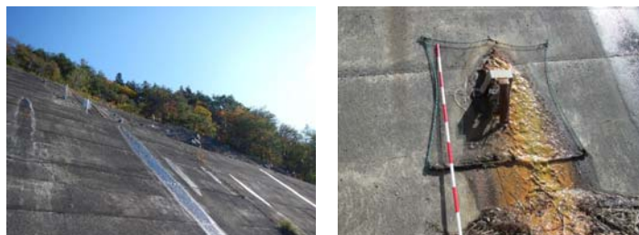
写真-1 もたれ擁壁の水抜き孔からの湧水 （左：第2のり面，右：第4のり面）
