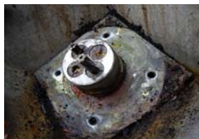
写真-1 変状アンカー写真
