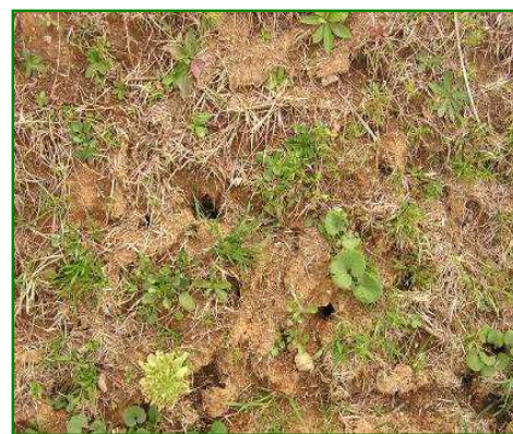
【写真-3】 モグラの穴が水みちとなり堤防決壊の原因になる恐れがある。
