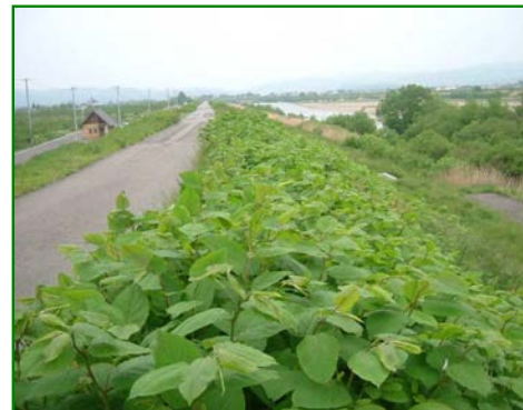
【写真-1】 堤防に繁茂するイタドリ。堤防の点検ができなくなる。
