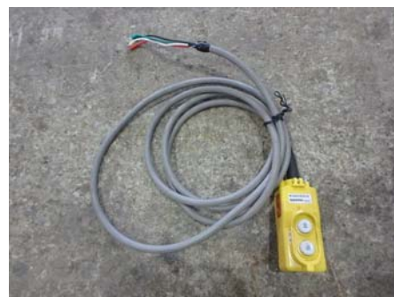
写真-3 仮設盤(走行スイッチ)
