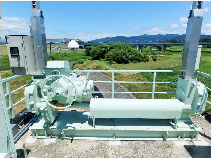
写真-1、電動ラック式開閉機
