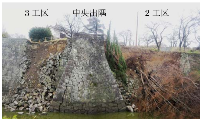
写真1 小峰城跡の竹之丸石垣の崩落状況 (白河市教育委員会提供)
