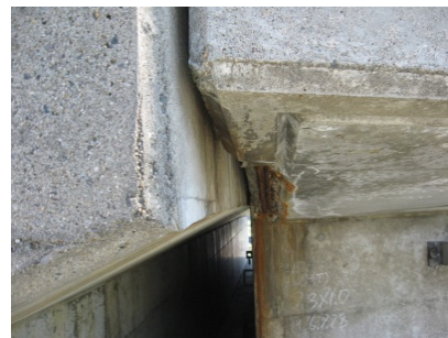
写真-1 桁端部の損傷状況
