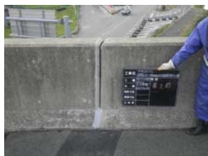
写真-3 地覆と舗装境界面の隙間
