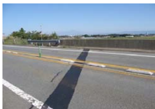
写真-2 伸縮装置の劣化状況
