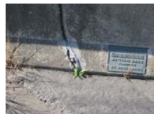
写真-4 既設止水補修材の劣化
