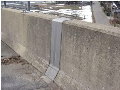
写真-5 越冬後の防水シート状況
