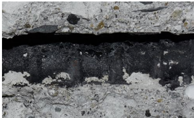
図-5 引張鉄筋塗布のはつり後のコンクリート画像
