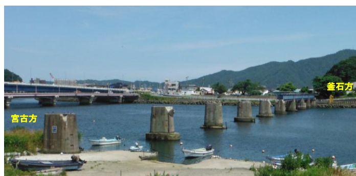
図-2 第 34 閉伊川橋りょう被災写真
