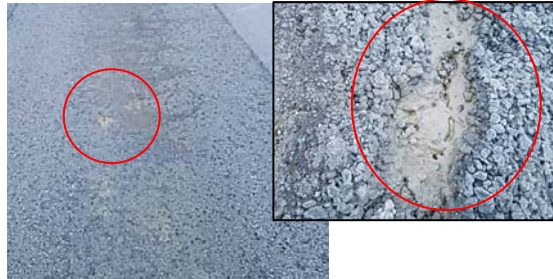
写真1 ポンピングによる損傷
