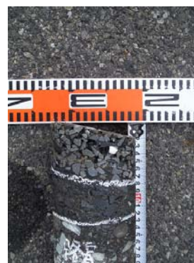
写真4 圧縮・変形した基層
