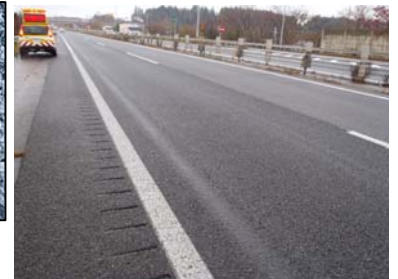
写真2 わだち掘れ形状の損傷
