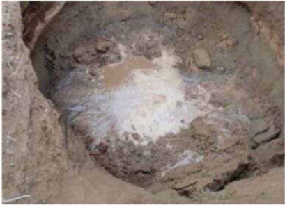
写真－1 湧水・地山状況
