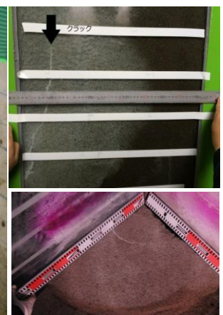
写-2 クラック発生状況
