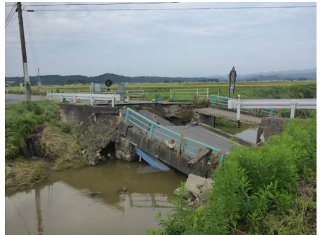
図 2 落橋した熊川橋
