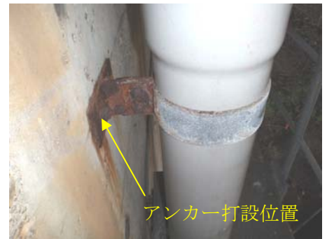
【写真-2 損傷状況】
