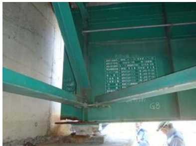
写真-2 損傷状況（内面）
