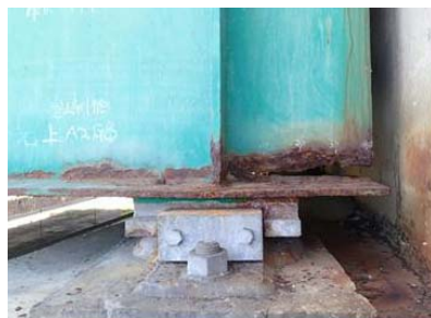
写真-1 損傷状況（外面）
