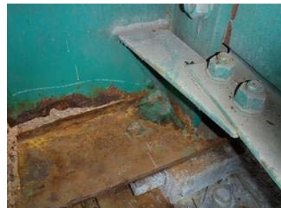
写真-3 損傷状況（接写）
