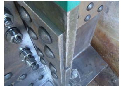
写真－9 垂直補剛材添接部
