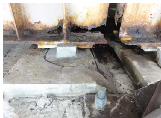
写真-2 桁端部腐食損傷
