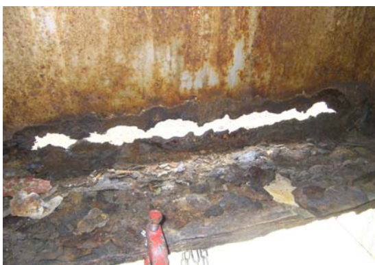
写真-1 主桁下フランジ腐食損傷
