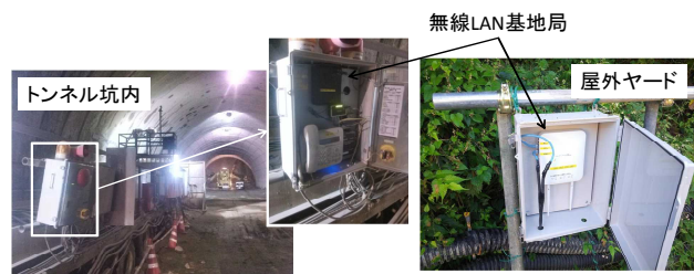
図ー1 無線基地局設置状況
