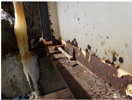
図-1 伸縮装置からの漏水による桁端部の腐食
