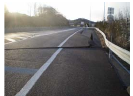
写真－1 東日本大震災後の状況
