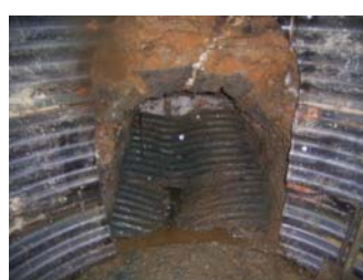
写真-5 下流側閉塞状況
