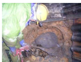
写真-4 上流側閉塞状況
