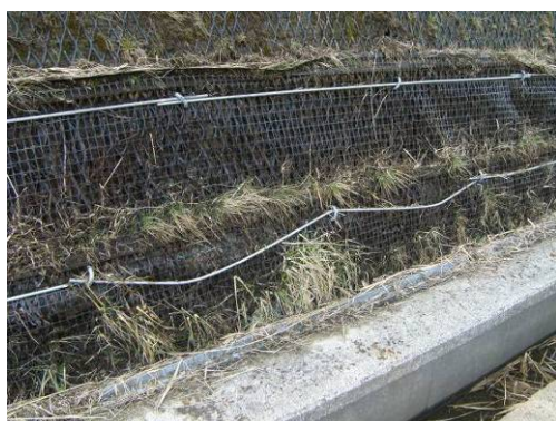
写真－3 融雪期浮上防止鉄筋の変状
