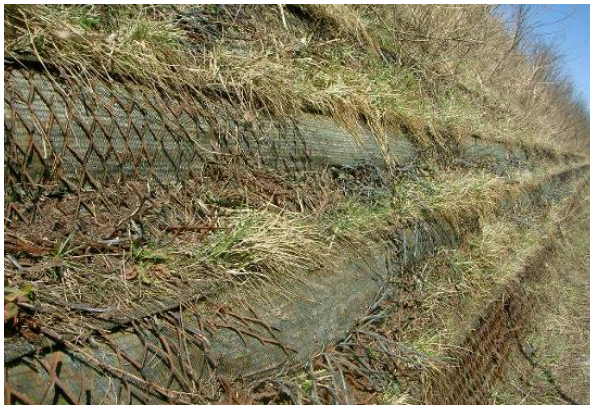
写真-1 壁面材の損傷状況
