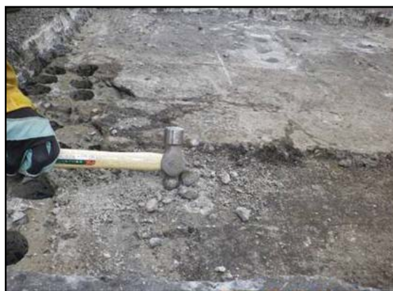
図2. 既設コンクリートとの剥離
